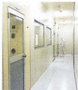
クリーン通路
